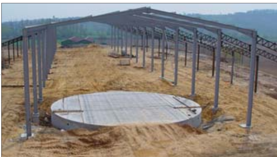
Vue de l'ossature d'un bâtiment d'exploitation en construction comprenant une fosse circulaire enterrée avec une couverture en caillebotis.
